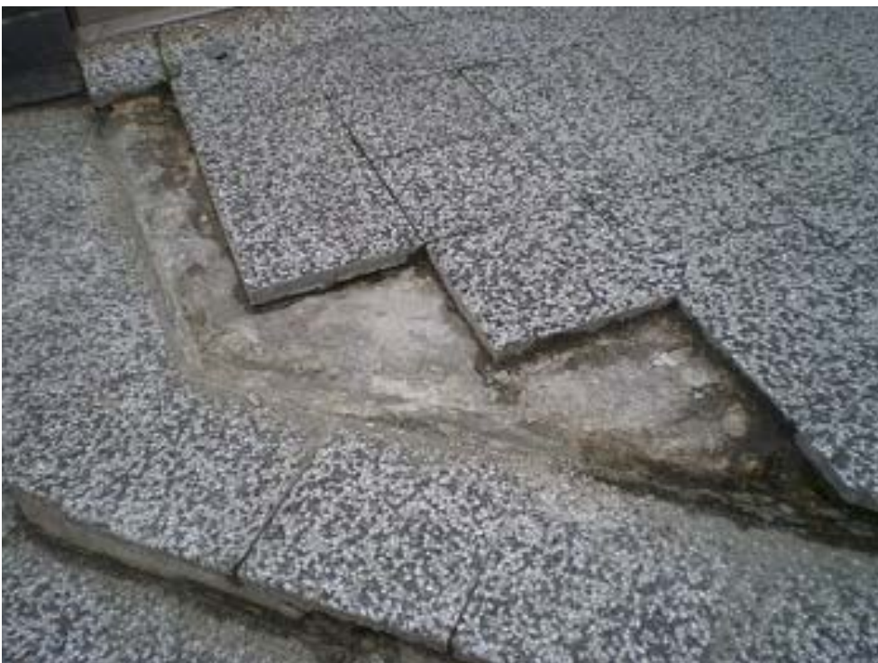
Kuva 24. McDonaldsin edessä olevat portaat ovat kunnostamatta, mikä lisää kompastusvaaraa merkittävästi.
