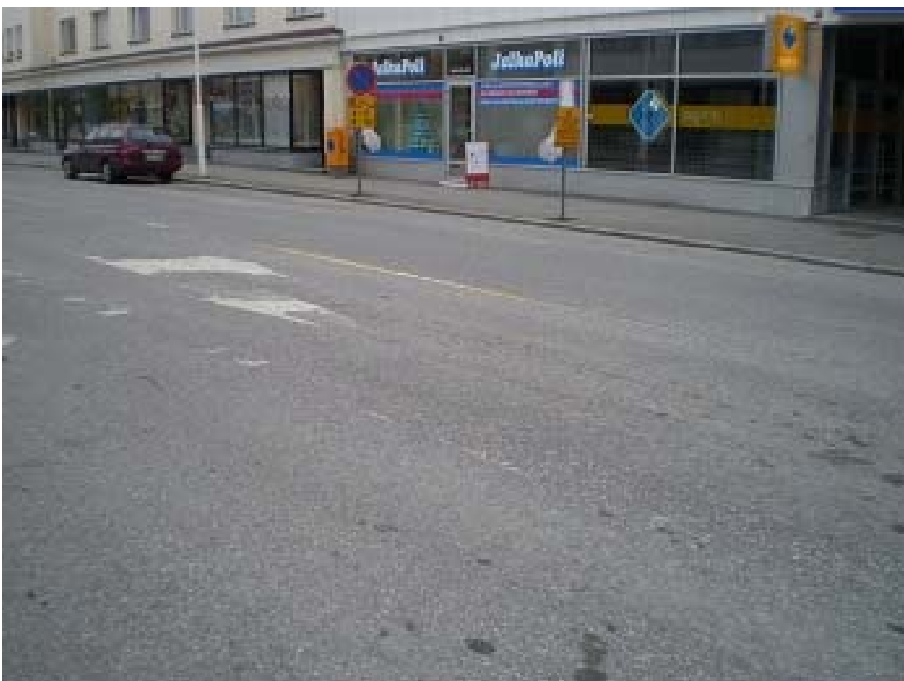
Kuva 40. Savonkadulla olevat tiemerkinntät todettiin kuluneiksi.
