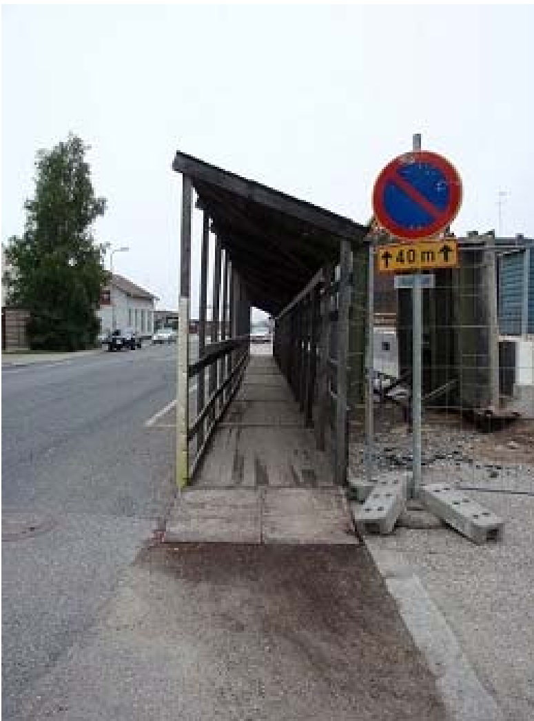
Kuva 30. Riistakadulla sijaitsevan työmaan vieressä oleva väliaikainen kulkuväylä koettiin kapeaksi ja vaikeakulkuseksi, mikä aiheuttaa turvattomuutta.
